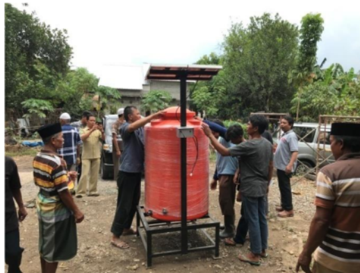
Gambar 5. Perakitan Pompa Air Tenaga Matahari
